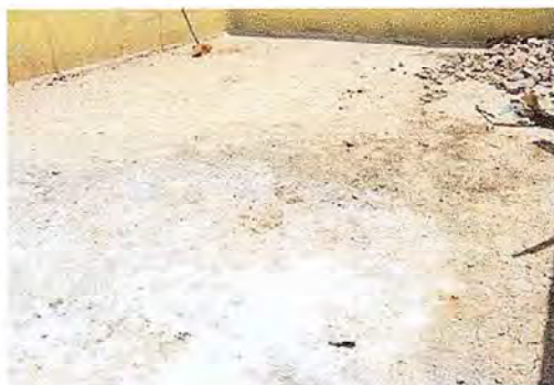
Foto 3: Se observa el levantamiento de piso en mal estado en Modulo I.
